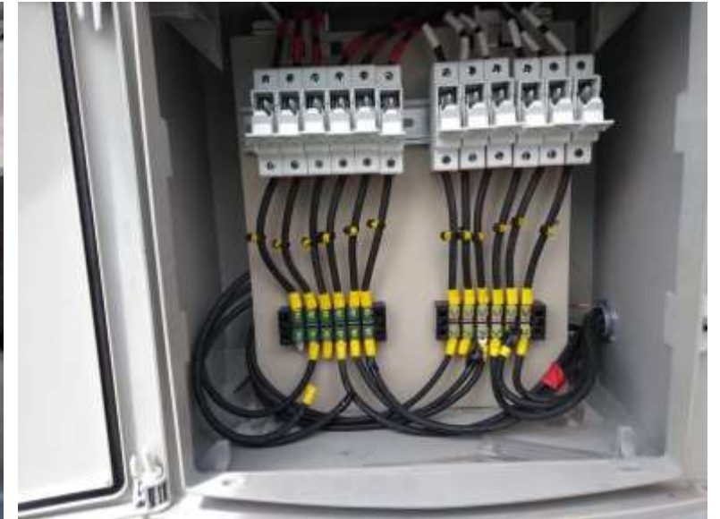
Sujeción inadecuada de los terminales de los cables
