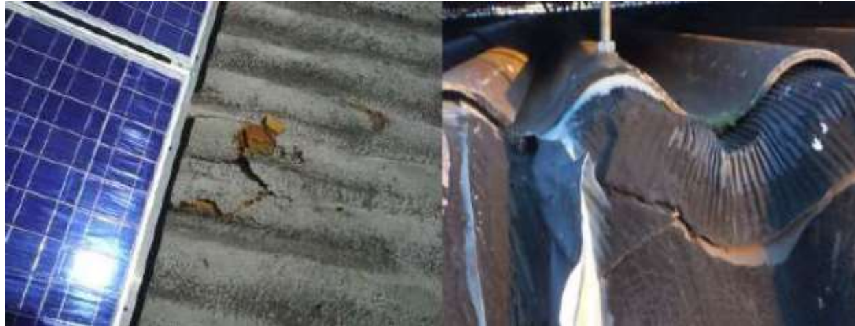
Daños en el tejado por tránsito de personas
