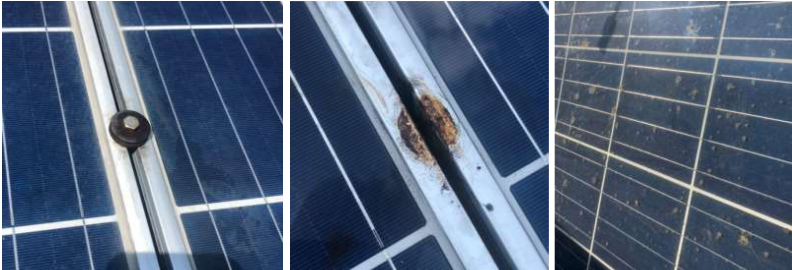
Sujeción de los módulos con abrazaderas inadecuadas
