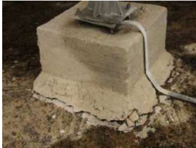
Pérdida de anclaje de la zapata de hormigón a la superficie del tejado
