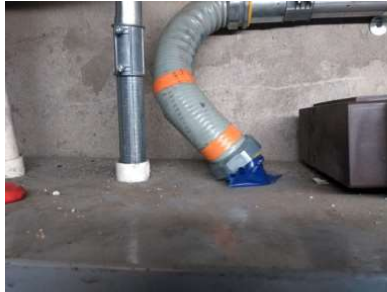
Mal acoplamiento de la tubería
